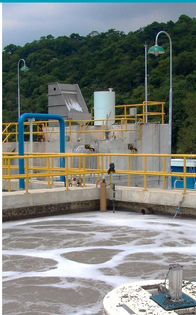
ETE (ESTAÇÃO DE TRATAMENTO DE EFLUENTES) ETA (ESTAÇÃO DE TRATAMENTO DE ÁGUA)
